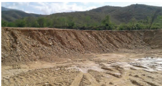
Fuente: Equipo de expertos de JICA, Rehabilitación Vertedero Azua, RD. 2017.- Foto 8. Problemas de erosión en el dique debido a fuertes lluvias
