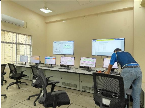
SCADA オペレーションルーム
