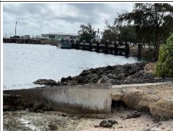
写真 2.7.33⑨ スリップウェイ底面洗堀状況
