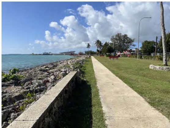
写真 4.1.13 ここから再び被災していた
