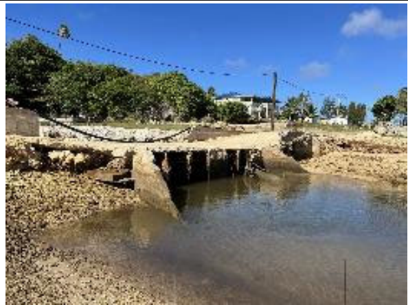
写真 2.7.22⑤ 既存橋梁(カルバート)破損
