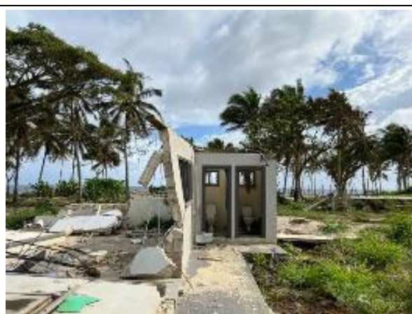
写真 2.7.2 津波に破壊された建物
