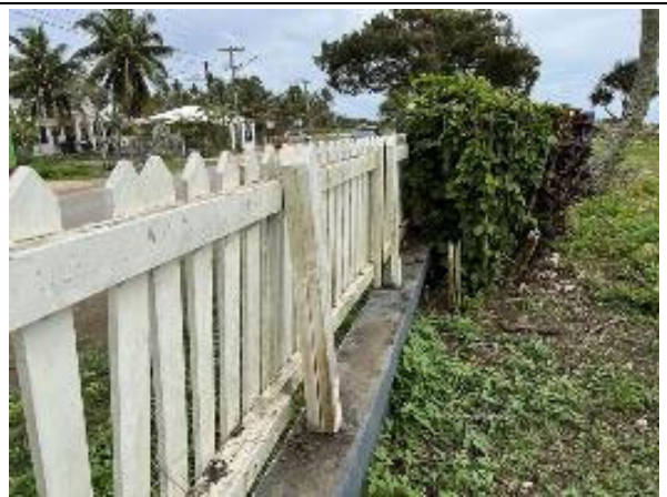
写真 2.7.6 津波に押されたフェンス
