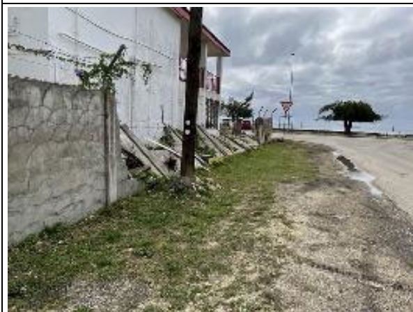
写真 2.7.9 津波によって壊れたブロック塀
