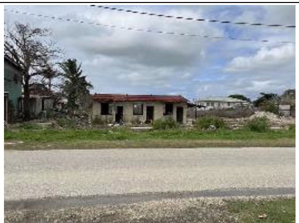
写真 2.7.10 津波によって洗われた民家
