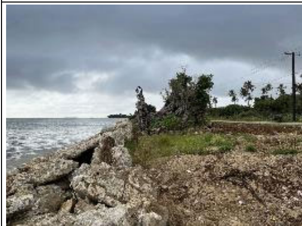
写真 2.7.13 コンクリート被覆破損状況
