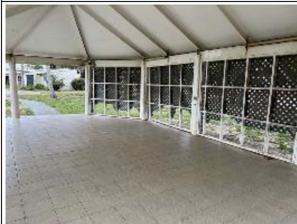
写真 2.7.7 津波によって下段の枠が壊れた
