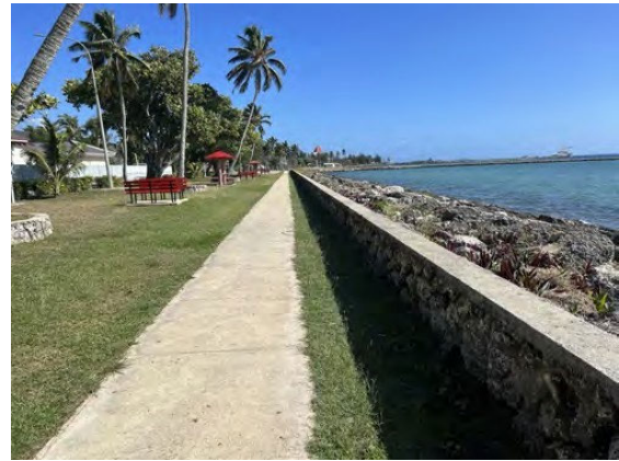
写真 4.1.12 一部では護岸の形状を保っていた
