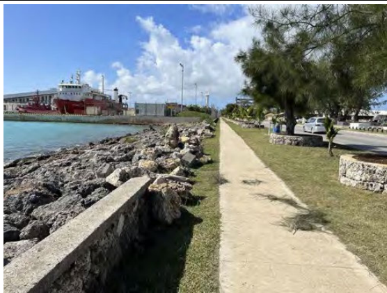
写真 4.1.15 ここから約 45mの範囲で崩壊
