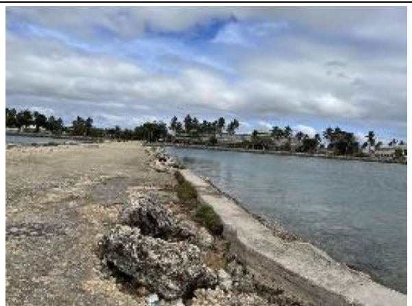
写真 2.7.8 突堤の西側部分の損傷
