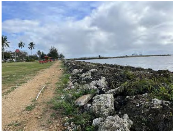
写真 4.1.11 ブナワーフまでの護岸が崩壊
