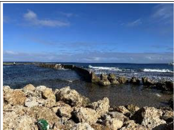
写真 2.7.18① 石積護岸が大きく崩れていた
