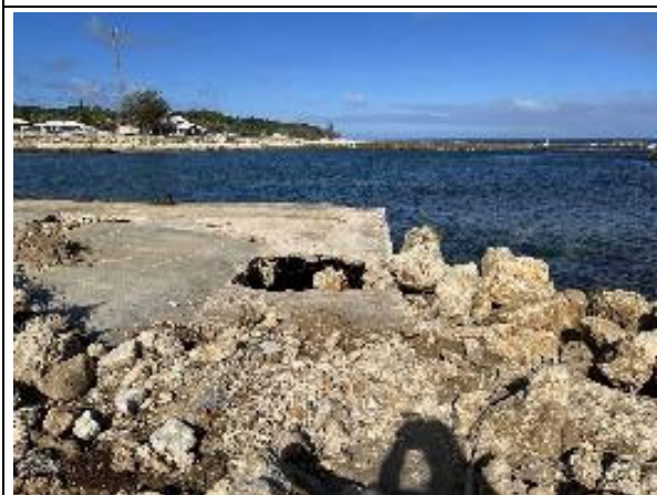
写真 2.7.19② 新港岸壁エプロン部の破損状況
