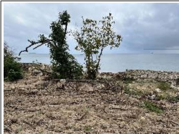
写真 2.7.11 石積護岸決壊状況
