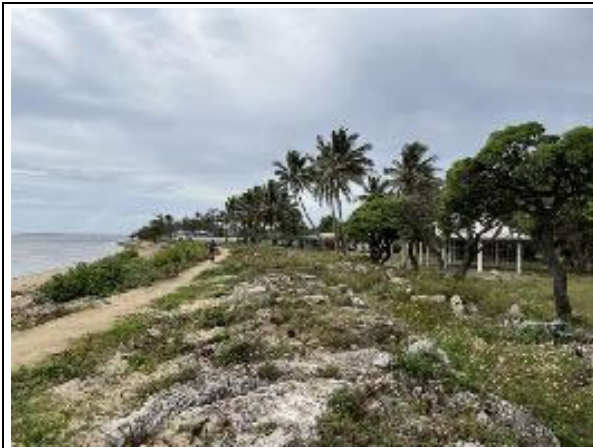
写真 2.7.5 石積護岸の石が散乱した
