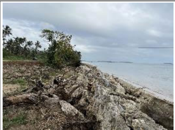
写真 2.7.12 石積護岸破損状況
