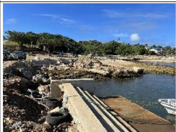
写真 2.7.20③ 新港小型船舶用岸壁破損状況
