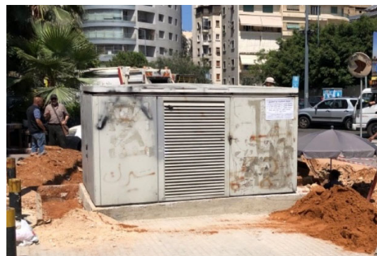
図 5.3-13 プレハブ式変電所(全体)
