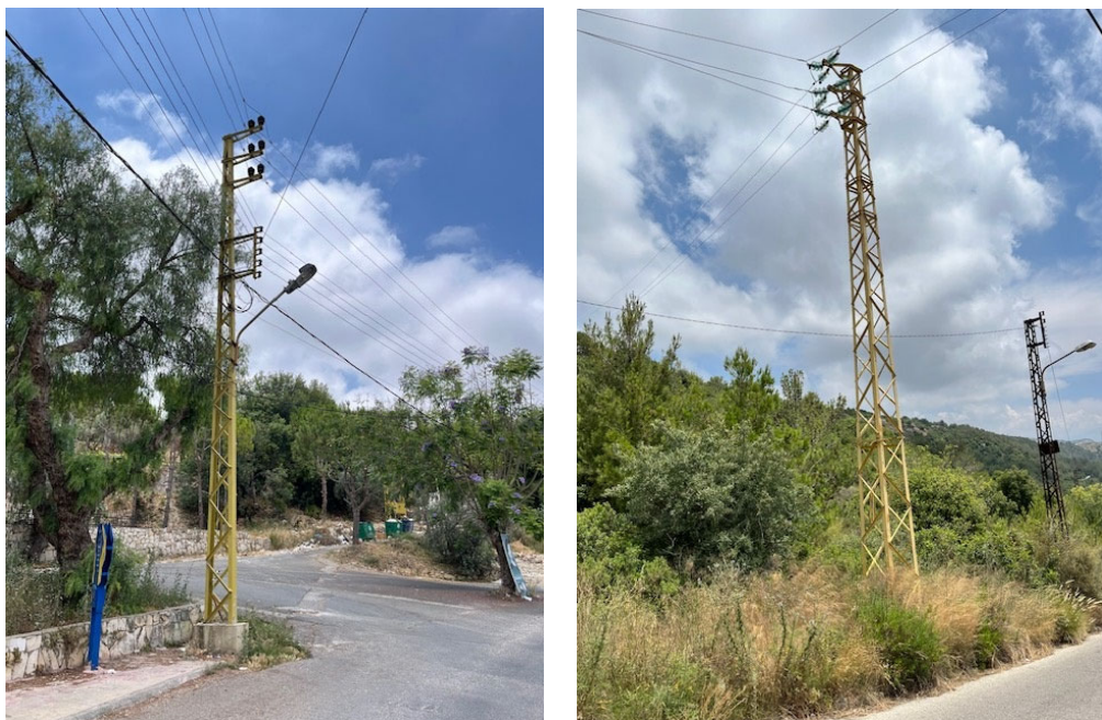
図 5.3-17 左: 引き通し装柱(全体)、右: 引き留め装柱(全体)
