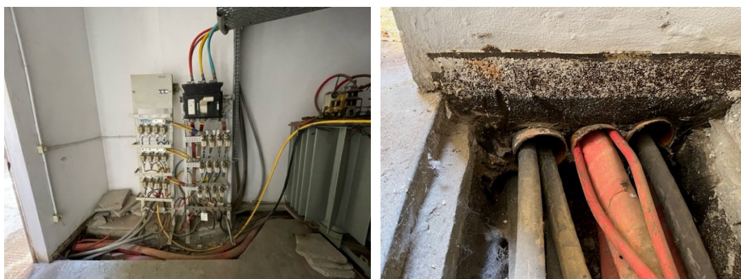
図 5.3-11 左:低圧分電盤、右:地中ケーブルの入線状況
