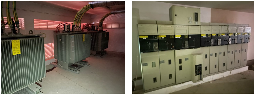
図 5.3-12 大型変電所(左:変圧器、右:中圧開閉装置)
