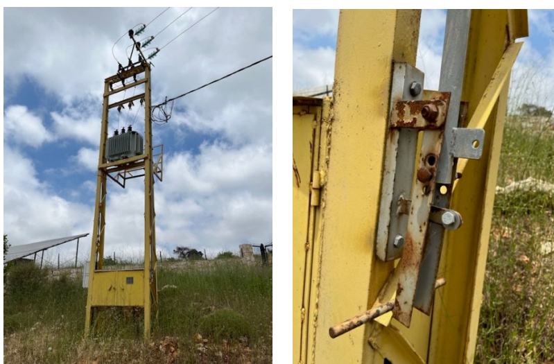
図 5.3-2 左:柱上変圧器(全体)、右:断路器の操作レバー
