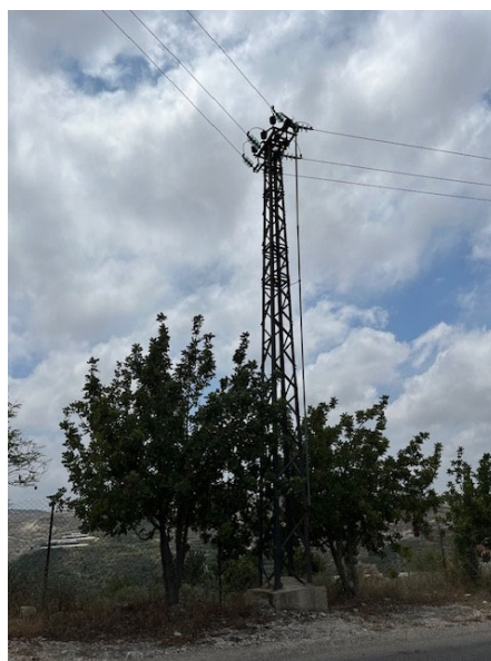
図 5.3-21 中圧配電線の断路器
