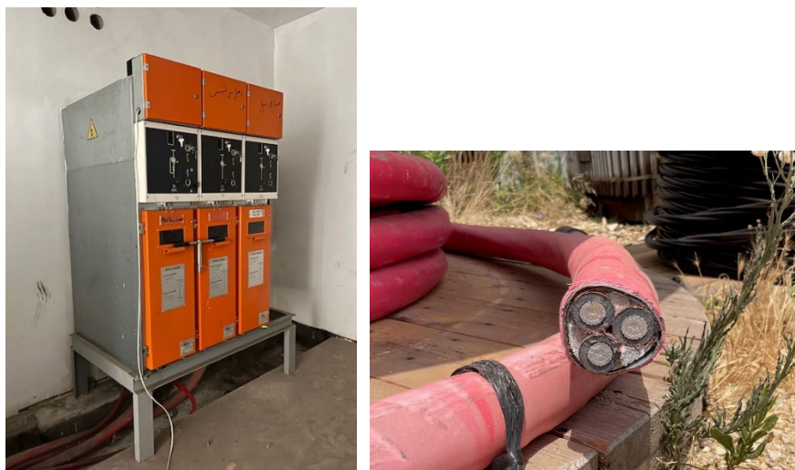
図 5.3-9 左：中圧開閉装置、右：中圧ケーブル
