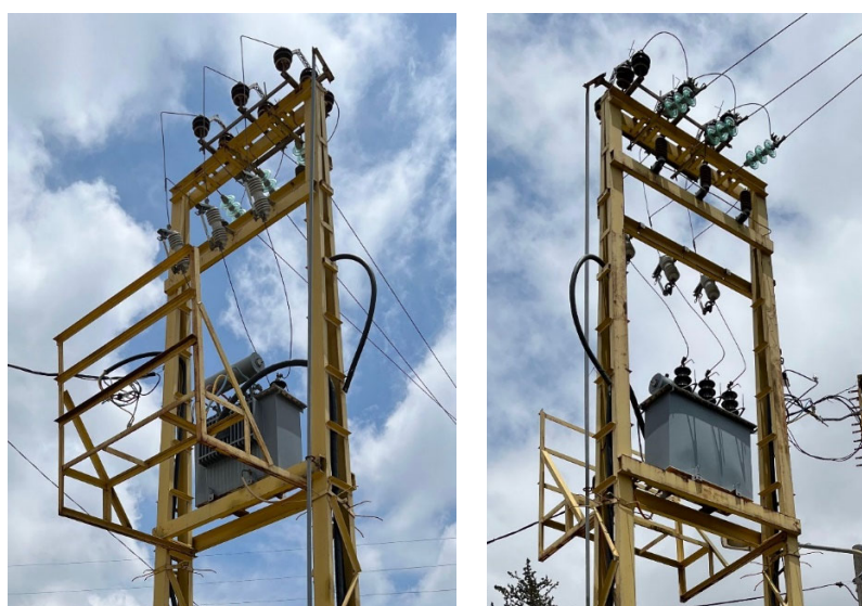
図 5.3-3 柱上変圧器上部(左:家屋側、右:道路側)
