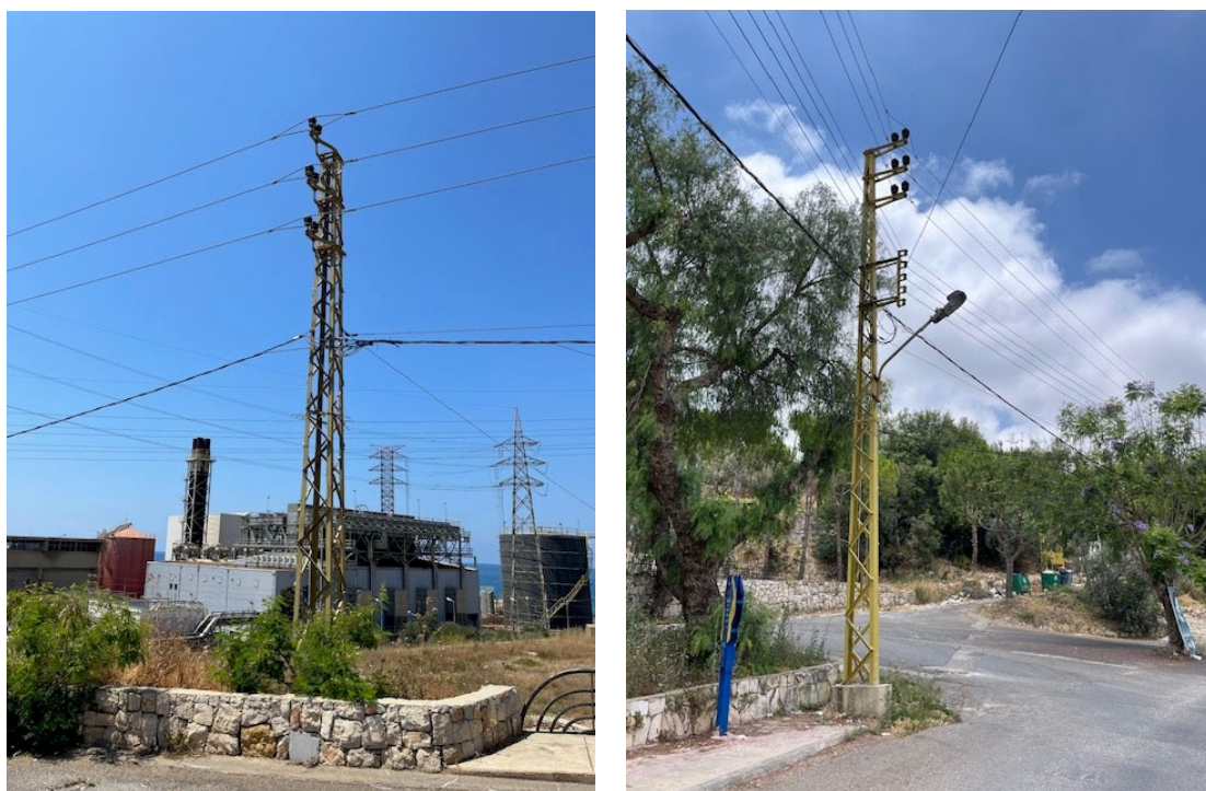
図 5.3-22 低圧幹線(右:絶縁電線、左:裸線)
