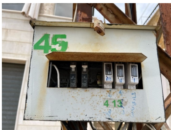
図 5.1-8 民間発電事業者のブレーカと計量装置
