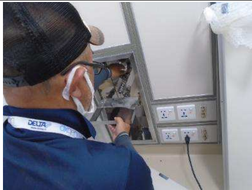
ICU 室の RO 水栓の動作確認の立ち合い
