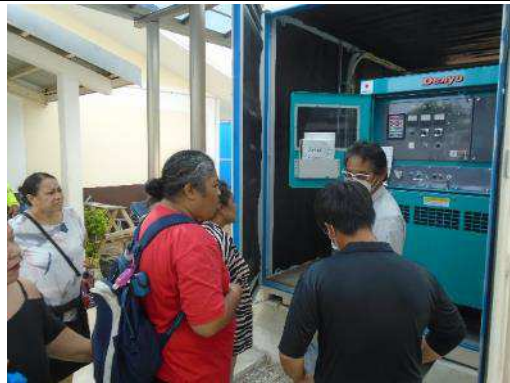
発電機の動作確認・使用方法の指導の立ち合い
