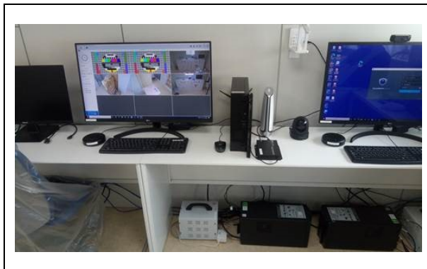
図 3-23 プレハブ ICU-遠隔 ICU 通信システム設置箇所
