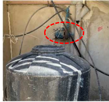
揚水ポンプ（左の写真の一番奥のタンク）
