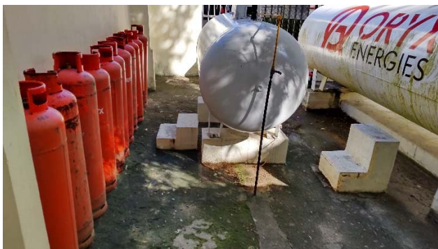
ダルエスサラーム/ホテルの LP ガス供給設備
