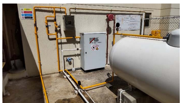
ザンジバル/ホテルの LP ガス供給設備
