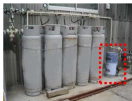
図3 ベーパーライザー設置の様子 シリンダー右に設置（破線囲み）
