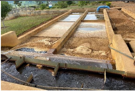
薬品混和池・フロック形成池
