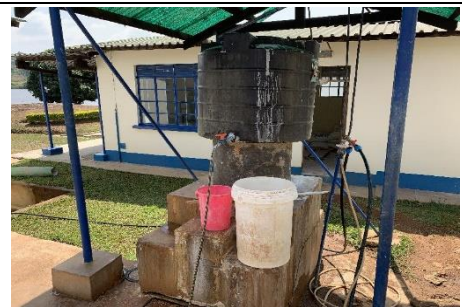
薬品注入設備
