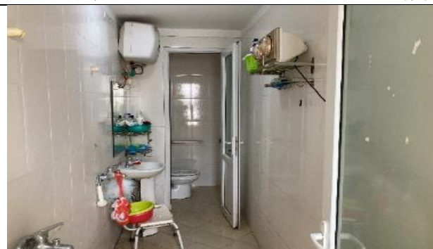
高齢者介護施設のトイレ、シャワー
