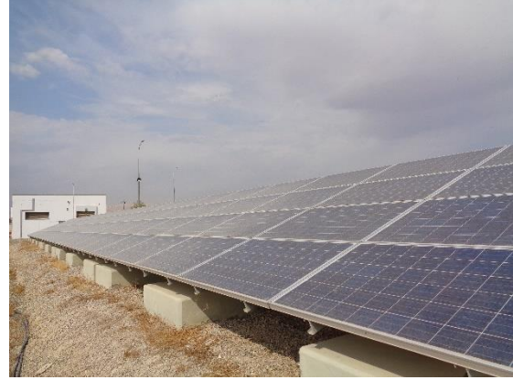
صورة 3- محطة الطاقة الشمسية
