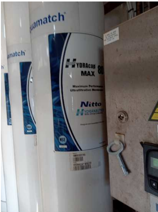
Ro filtration unit (Nitto Denko Co.)
