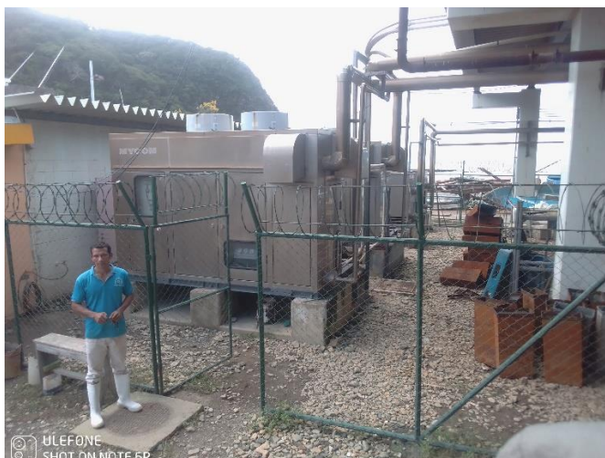
図 7-24 漁業用の冷蔵施設の熱交換器
