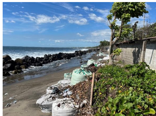
Dike で防護しているが侵食発生
