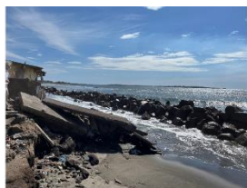
3. 侵食・高波被害の家屋
