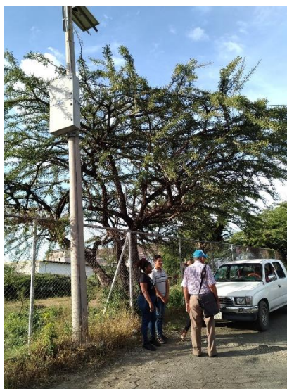
写真3 早期警報用のサイレン
