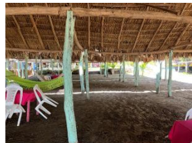
2. レストラン内部で浸水発生
