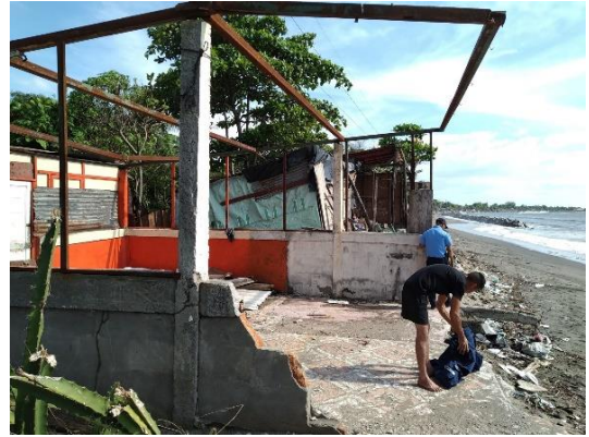
既に廃屋となった建物（視察地点3）
