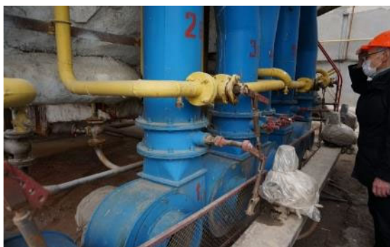
Котельная № 1 г. Ташкента, вентиляторы подачи воздуха для горения и газовые трубы
