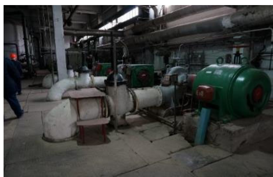
Котельная № 1 г. Ташкента, изоляция сетевых насосов и труб
