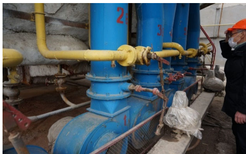
Вентилятор воздуха для горения и газопровод (ТЦ-1, Ташкент)
