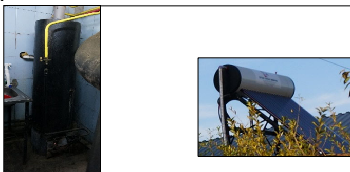
Рисунок 4-14 Водонагреватели (слева: газовый, справа: солнечный)
