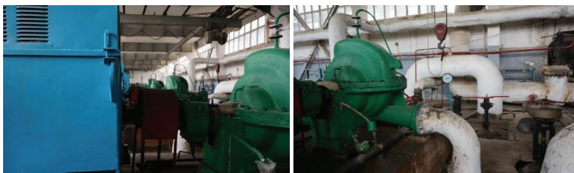
タシケント市 No8 地域熱供給所の温水供給ポンプと電動モータ
