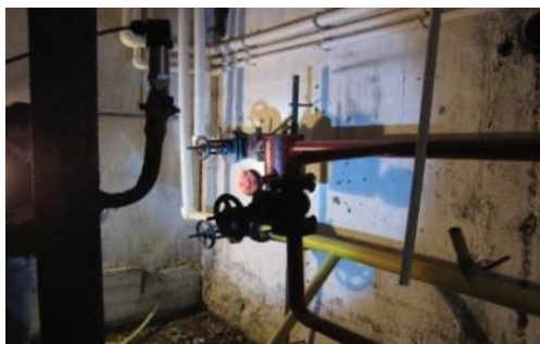
上図 タシケント市 No8 地域熱供給所の返送水配管の断熱施工
