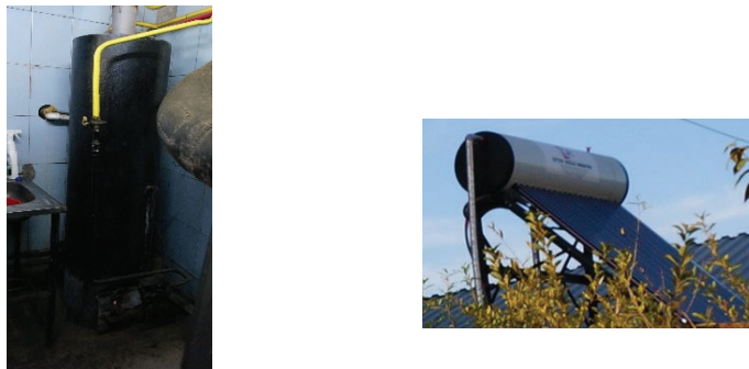
図 4-14 給湯器外観（左：ガス給湯器、右：太陽熱給湯機）
