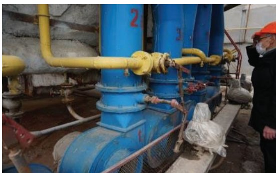
タシケント市 No1 地域熱供給所の燃焼空気供給ファンとガス配管
