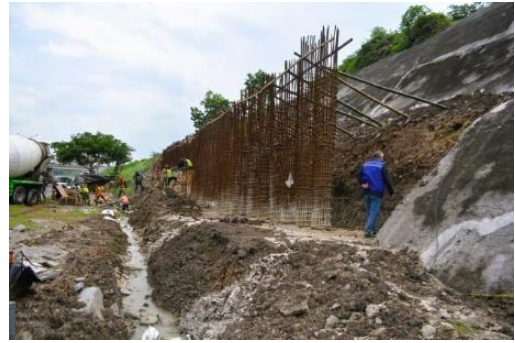
2022年12月 高速道路 法面崩壊現場視察
