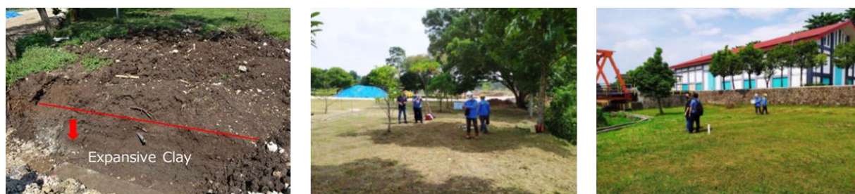
図 9 現地で確認された膨張性粘土 (左)、性能試験候補地点 (Area-1 & Area-2)
