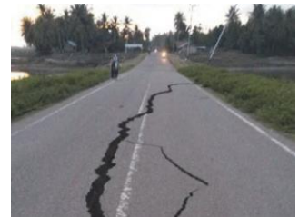
図2 道路の舗装破壊 (東ジャワ州マデウン県)
