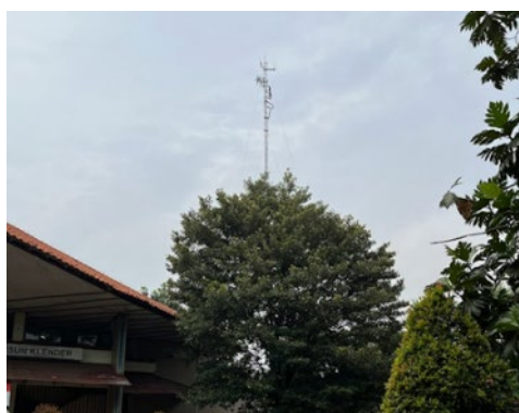
テスト用 Gateway を設置した電波塔
