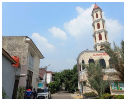
モスクタワー内 Gateway 設置 (PGN COM 実証現場)
