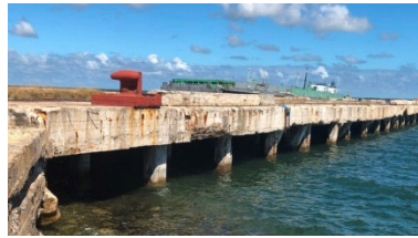
Deterioro de un muelle
