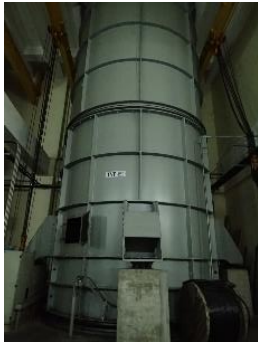
トンネル排風機 (サイゴン川トンネル換気設備)
