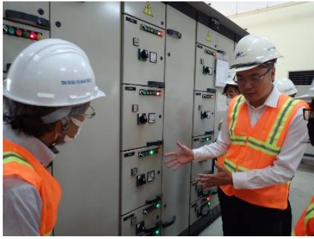
トンネル電気室状況確認 (サイゴン川トンネル電気室)
