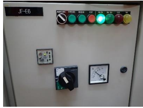
既設換気動力盤 (サイゴン川トンネル電気室)
