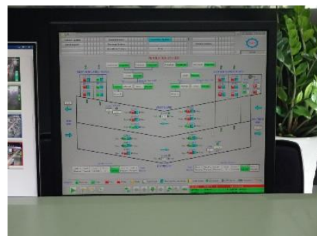
トンネル換気制御状況確認 (サイゴン川トンネル管理センター)
