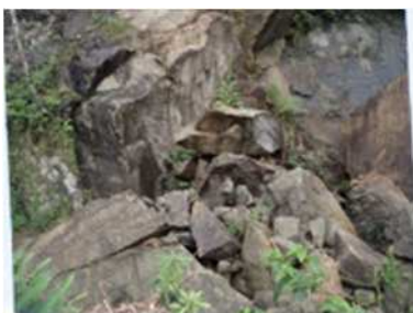
州道路斜面（岩盤崩落箇所）
