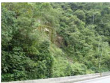
州道路斜面（表層崩落箇所）
