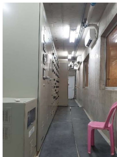
配水ポンプ場操作室
