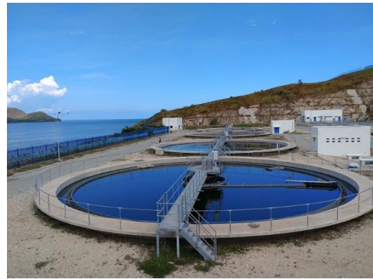
本事業で整備されたジョイスベイ下水処理場 (出典：日本経済研究所)
