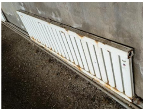
中国式ハウスの暖房用ラジエーター
