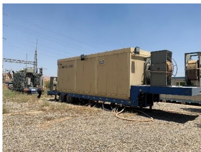
移動式変電所
