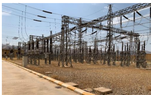
本事業で建設されたチュワルタ変電所 2
