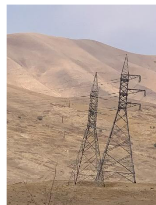
チュワルタ変電所からの 132kV 送電線
