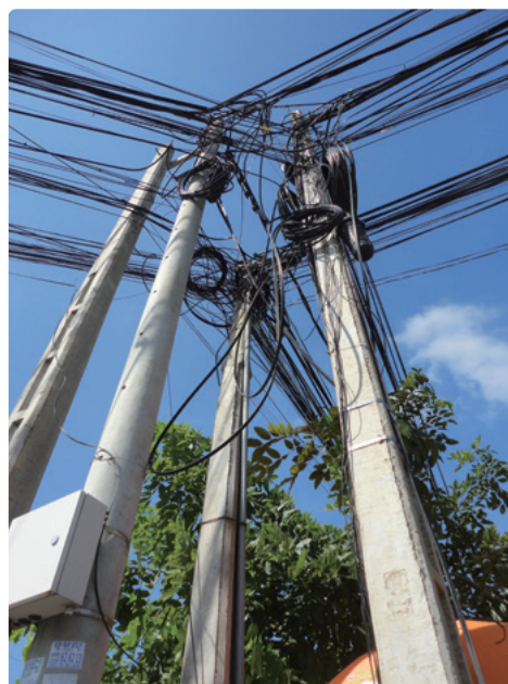
Local access cable (overhead line)
