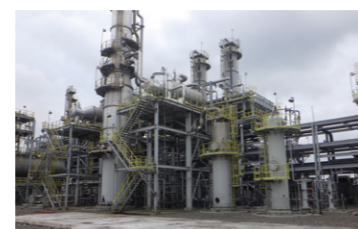
プルタミナ社 天然ガス生産プラント
