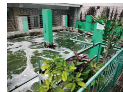
バングラデシュ「中小企業振興金融セクター事業」で融資を受けて整備された輸出用衣料クリーニング設備の排水処理施設
