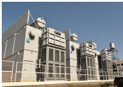
アクラセントラル変電所（出所：評価者撮影）
