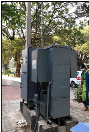
開閉器システム
