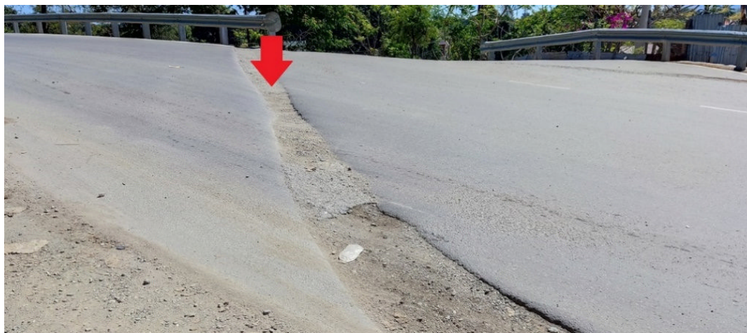
(参考) 写真 9：アクセス道路上の凹凸箇所 (凹みが発生している) (2021 年 10 月撮影)
