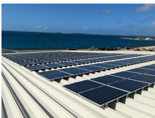
旅客ターミナルビルの屋根に設置された 太陽光パネル（外部評価者撮影）
