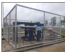
実証実験用の新規井戸 (Kedungtuban 井戸)
