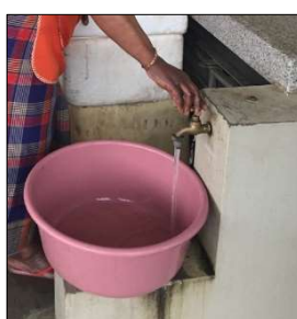
各区画に設置された水栓蛇口
