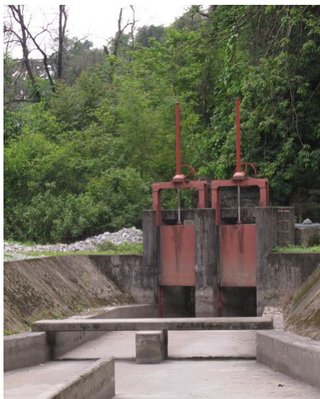
幹線水路のゲート
