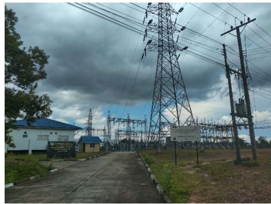
タオタン変電所
