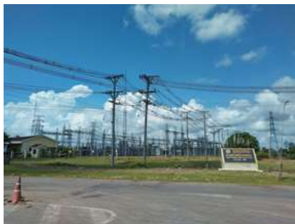
サラワン変電所
