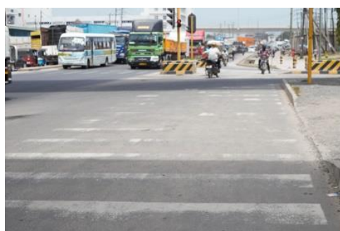
道路標示（標示が薄れている）
