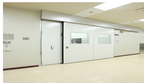
高気密陰圧型 クリーンルーム
