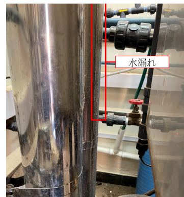
写真 14：透析用水装置からの水漏れ
