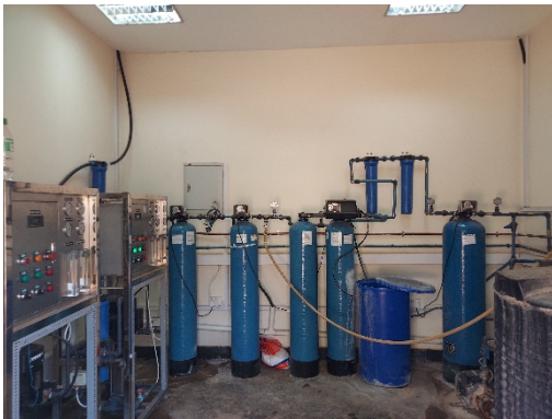
写真 11：現在使用中の透析用水装置（その 1）
