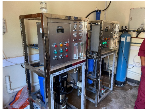
写真 12：現在使用中の透析用水装置（その 2）
