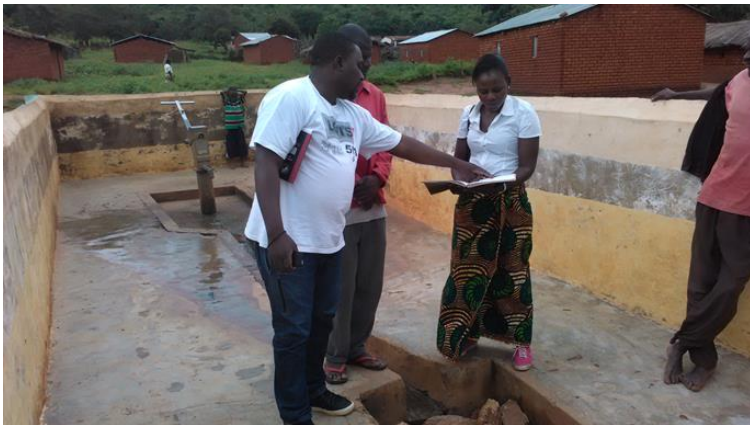
本事業で建設された深井戸（ムチンジ県モロシヨ No. 2 給水点）。本事業で実施された維持管理研修はWPCに有益だった。
