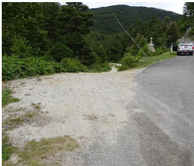
本事業の調達機材を使って建設されたブムタン県の農村道路。国道に接続しており、Chungphel 村の住民の公共施設へのアクセスが容易になった。
