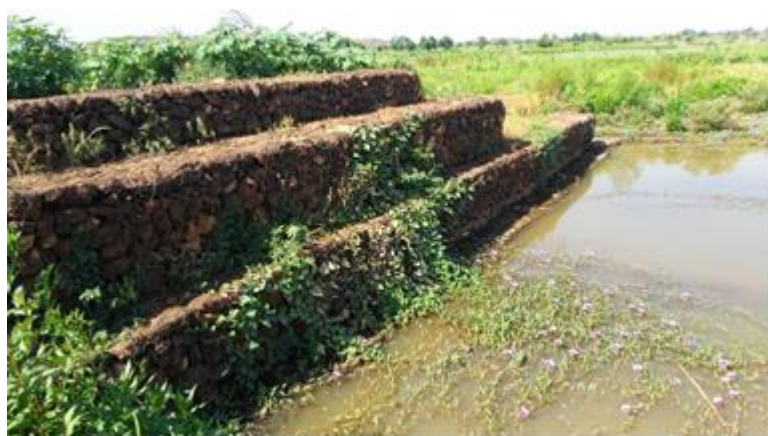
タウア州、ブルディ 2 の良好な状態の貯水池
