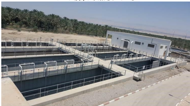
下水処理場は本事業で訓練された職員によって適切に維持管理されている
