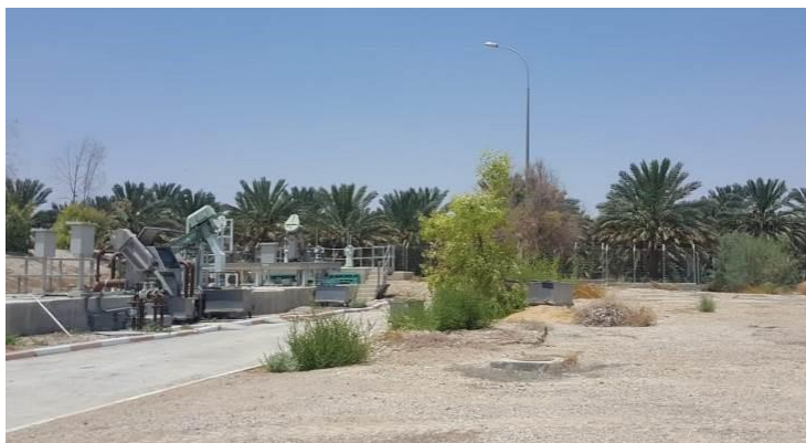
下水処理水は貯水池に貯められ、周りに設置されたポンプを使ってナツメ農家に供給されている
