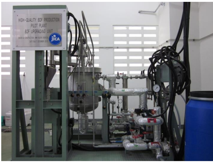
TISTR に設置された水素添加装置の一部
