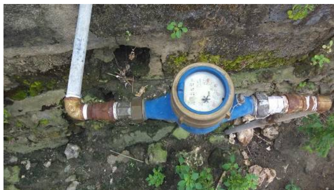
各戸接続された水道メーター：フェーズ 1 プロジェクトで使用された旧式の水道メーター（マカダラ地区）
