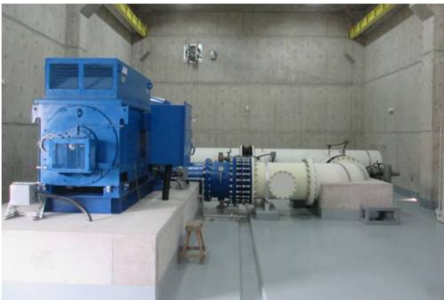
コンセプション発電所 建屋内 全景
