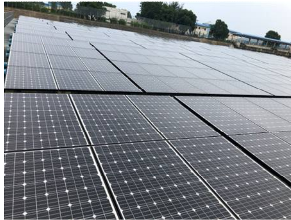
本事業で設置された太陽光モジュール
