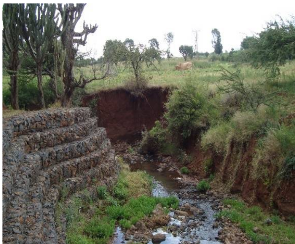
イシオロサブ川流水区にて本事業期間中に建設された護岸の様子
