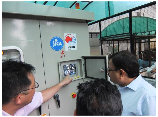
アムールの中小企業に設置された電気ヒートポンプ
