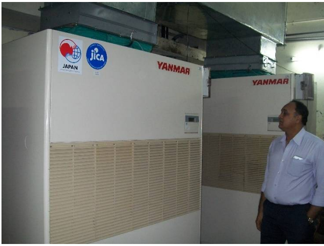
ラジュコットの中小企業に設置されたガスヒートポンプ
