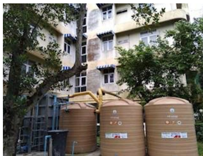
シーナカリンウィロート大学による排水処理・再利用
