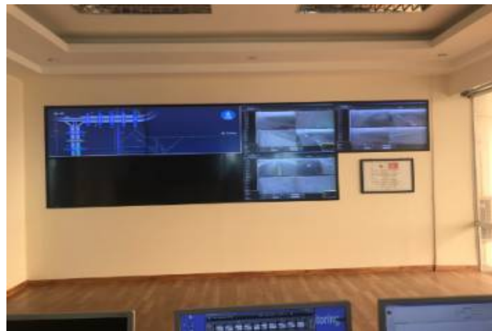
オペレーションルーム
