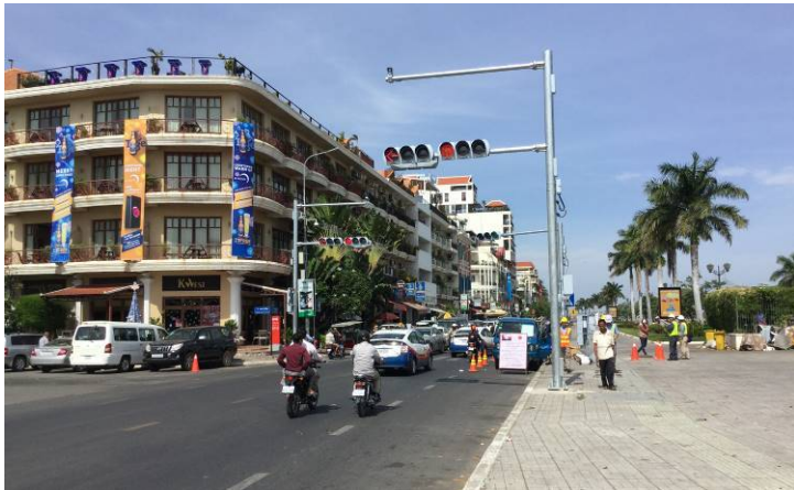
プノンペンの交差点に設置された新しい交通信号システム
