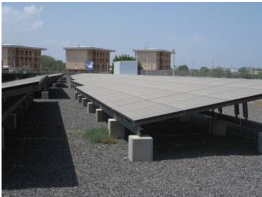
CERDのソーラーパネルと太陽光発電制御室（後方の白い立方体）
