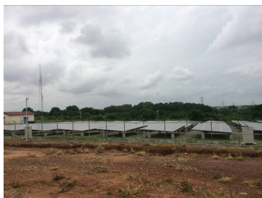
315kWp システム（当初計画分）
