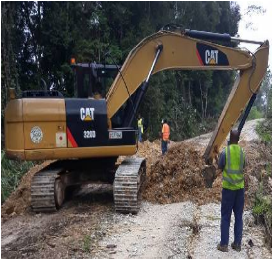
図1 西ハイランド州事務所から貸し出された機材を用いて行われた北ハイランド州での災害復旧作業
