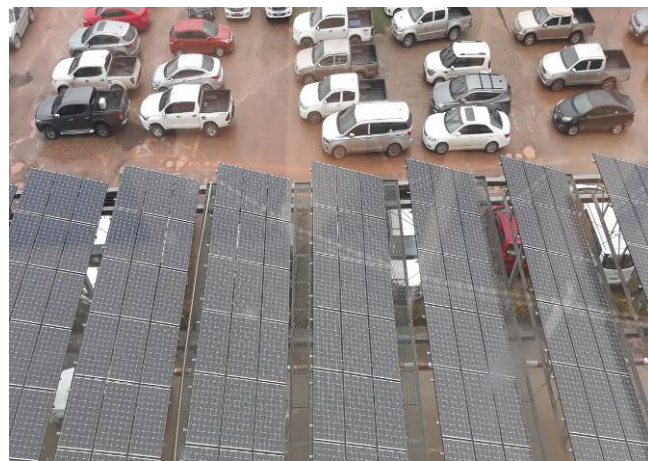
太陽光発電システム
