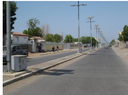
JICAの支援で1997年に建設された道路の中央分離帯上に設置されたソーラー街灯
