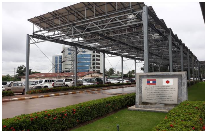
ラオス電力公社の太陽光発電システム
