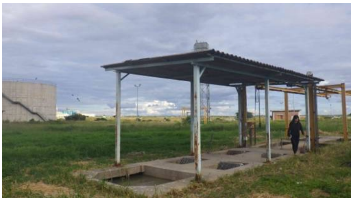
ゼンザ下水処理場の沈砂池
