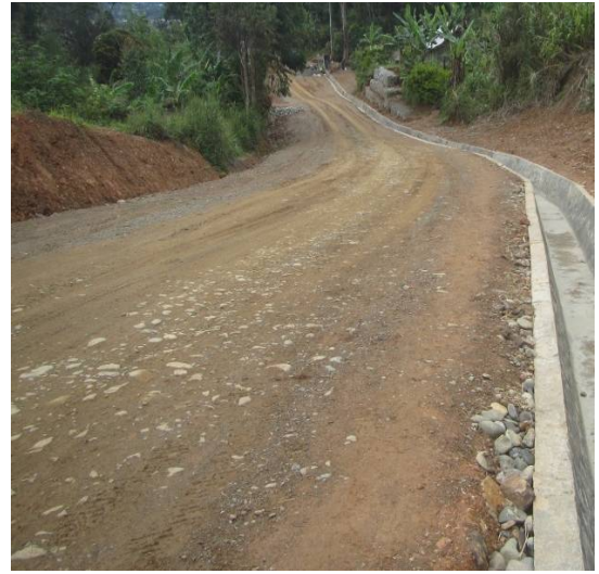
図2 調達機材を用いて行われた西ハイランド州での道路維持管理作業
