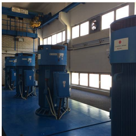
マレザ新ポンプ場の4台のポンプ
