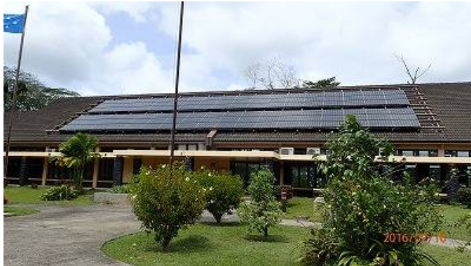
連邦政府複合施設内の大統領事務所の屋根に設置された太陽光発電システム
