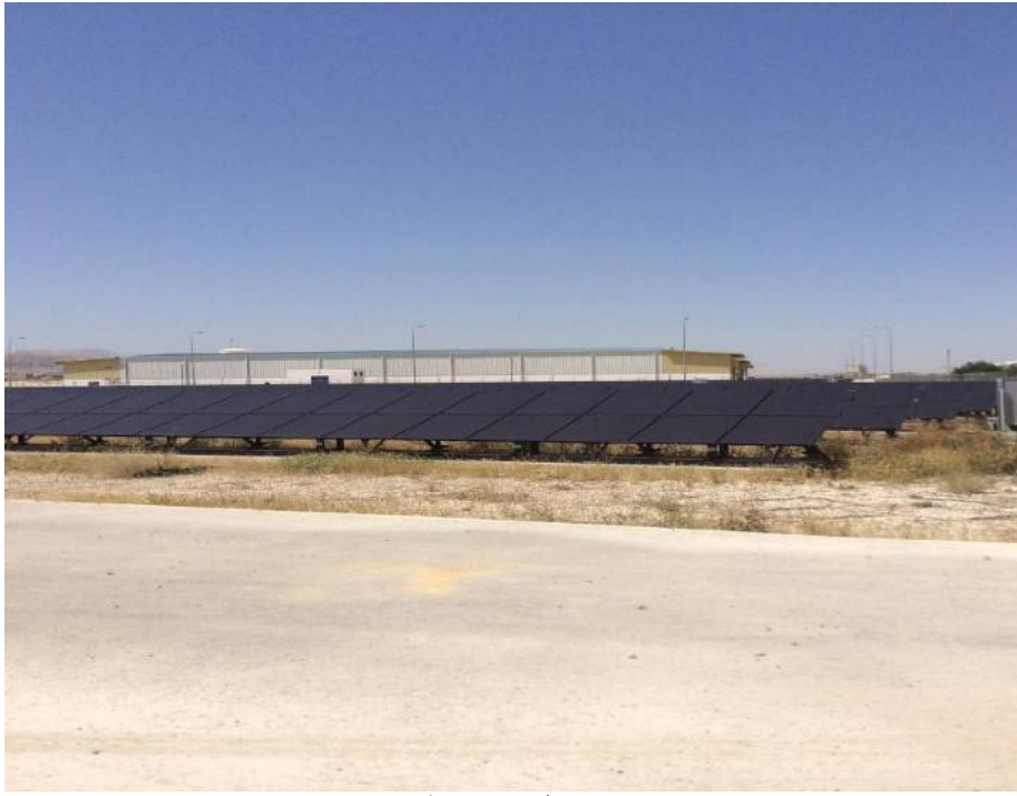
太陽光パネル
