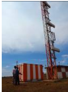
計器着陸装置 (グライドパス)
