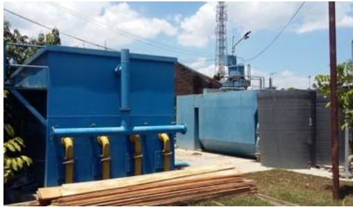
ゴワ県 PDAM の、新たな貯水池と浄水場
