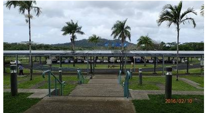
マイクロネシア短期大学（パリキールキャンパス）の駐車場の屋根に設置された太陽光発電システム
