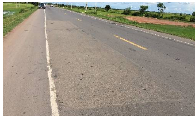
維持管理工事が実施された国道 6 号線（シエムリアップ州：クロン・セレイ・ソファン・クロン・シエムリアップ間）
