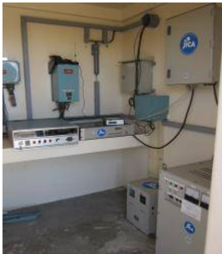
本事業で提供された機材 (水位計測サブシステム)
