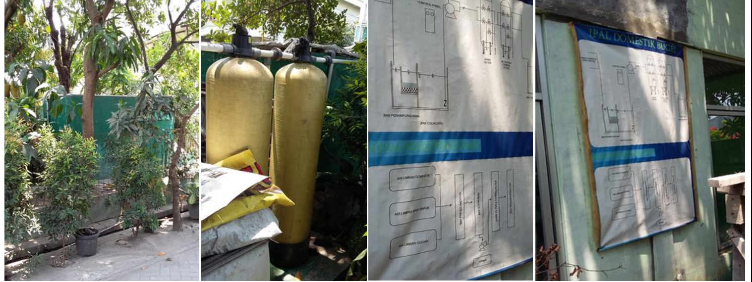
コミュニティ排水処理場
