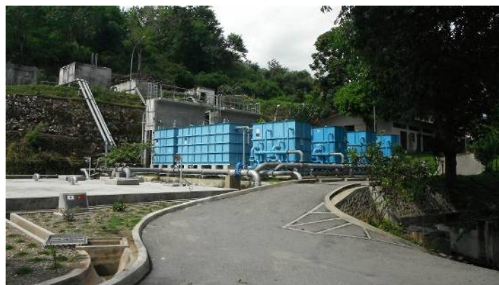
ベモス浄水場
