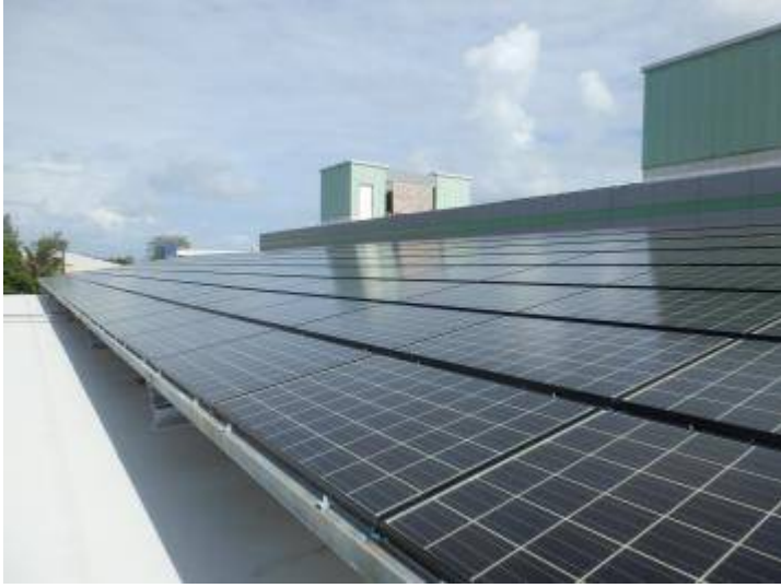
太陽光発電モジュール
