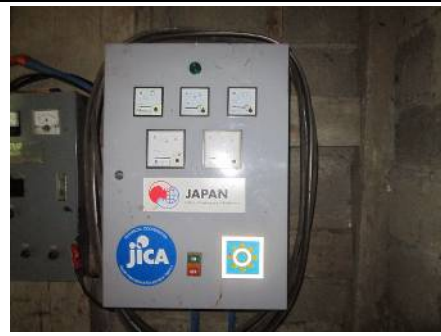
負荷制御装置
