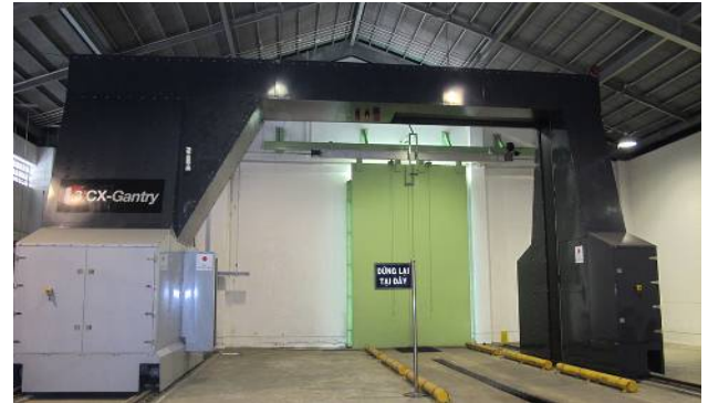
X 線検査機材用設備
