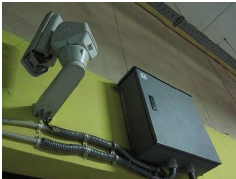
カメラが下を向いてしまったまま故障している ベラワン港 CCTV カメラ
