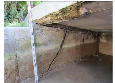
水路橋直下水路側壁部亀裂
