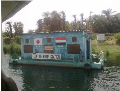
フローティング式ポンプ施設
