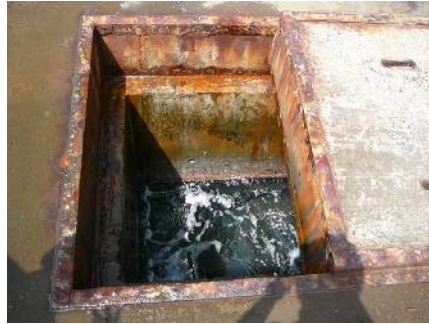
金属部分の錆により取り外しが困難なコンクリート蓋
