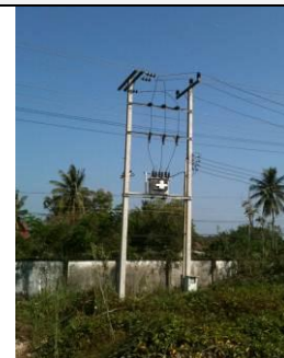
低電圧（22kV）の変圧器
