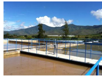
サラマ市浄水場における緩速ろ過システム
