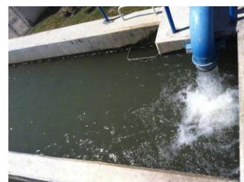
カバーニャス市浄水場の流入水貯水タンク
