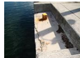
一部コンクリート剥離
