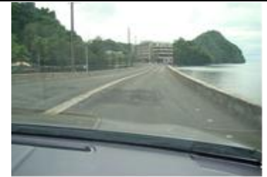
マラカルコースウェイ補修箇所 （水道管破裂）
