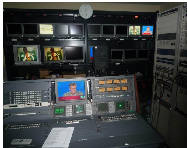
本事業で整備された主調整室
