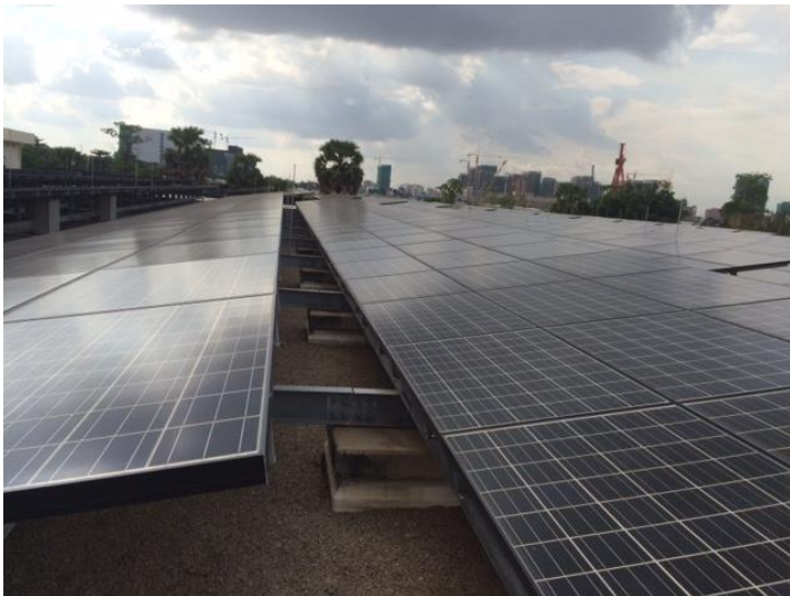
プノンペン水道公社屋上に設置された太陽光パネル
