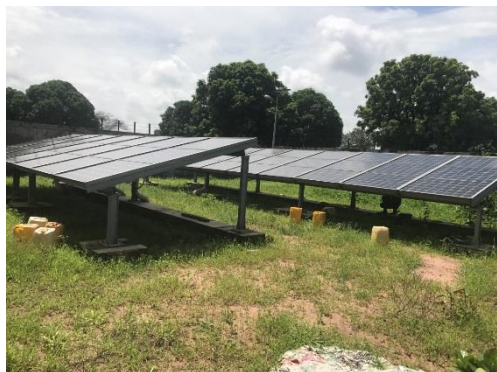
給水施設のソーラーパネル
