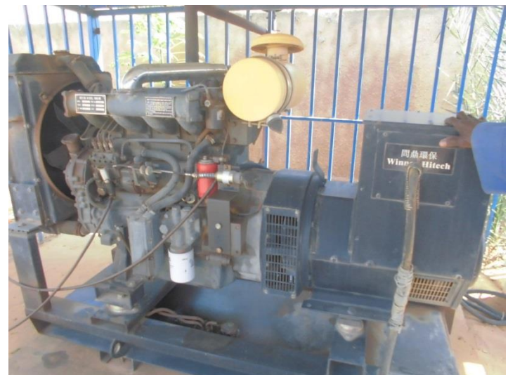
リボレ（ティラベリ州）での SEEN による発電機の使用
