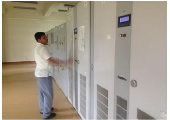
適切に稼働しているパワーコンディショナー
