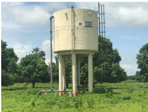
給水施設のタンク
