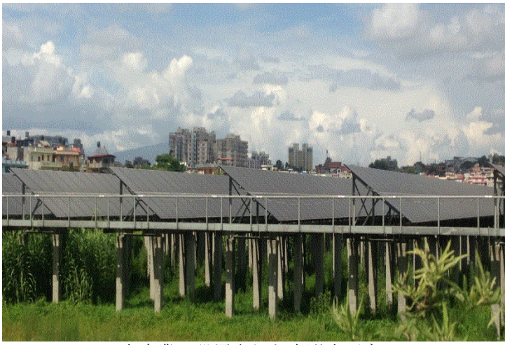
本事業で設置された太陽光パネル
