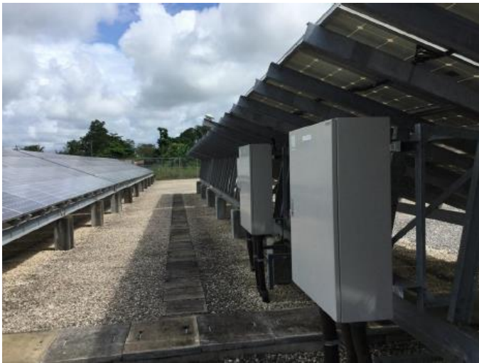
(日射センサーと太陽光パネル)
