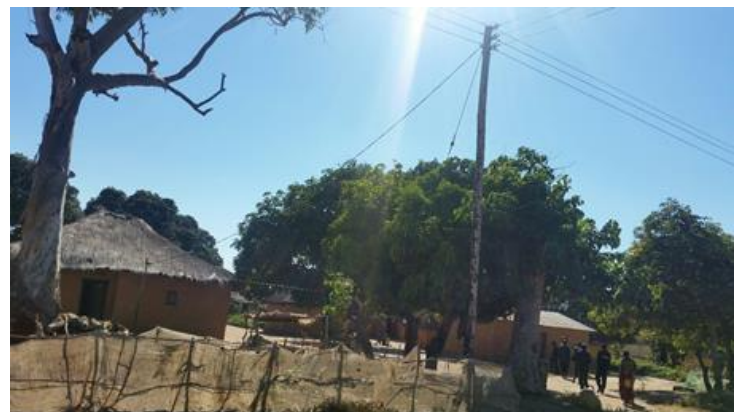
サンフィアに設置された太陽光発電システム
