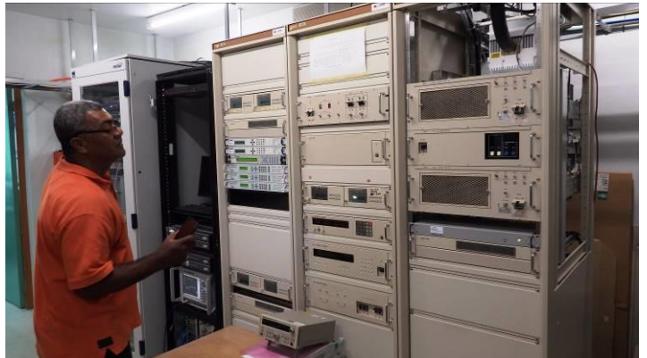
南太平洋大学 IT 職員によるコンピューターサーバーの点検
