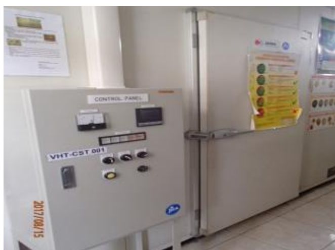
検査所内の果実保管のための冷蔵庫
