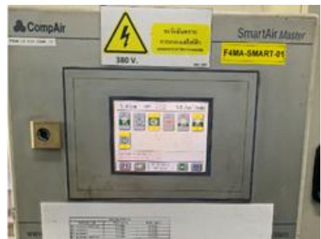
写真 6：コンプレッサ台数制御盤 2022 年 10 月
