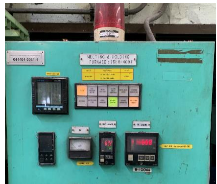
写真 4：電力の見える化装置 2022 年 10 月
