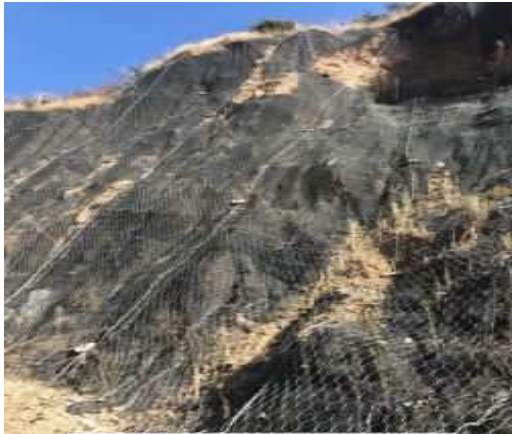
ブータンインド軍管理道路に インド軍が設置したネット
