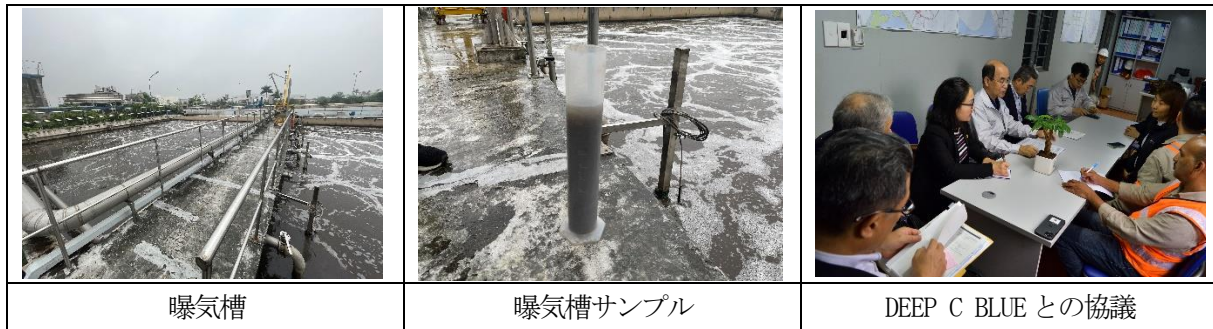
写真 45 DEEP C BLUE 排水処理設備視察、及び協議 (出典：調査団)
